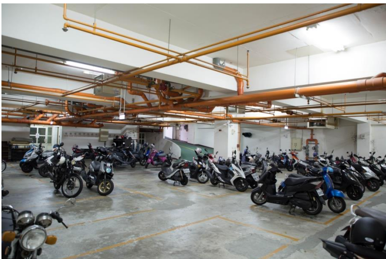
地下室停車場 parking
